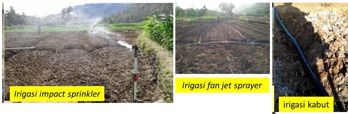
Gambar 36. Instalasi 3 teknik irigasi ( impact sprinkler , fan jet sprayer , dan kabut) pada tanaman bawang merah di Kecamatan Imogiri, Kabupaten Bantul
