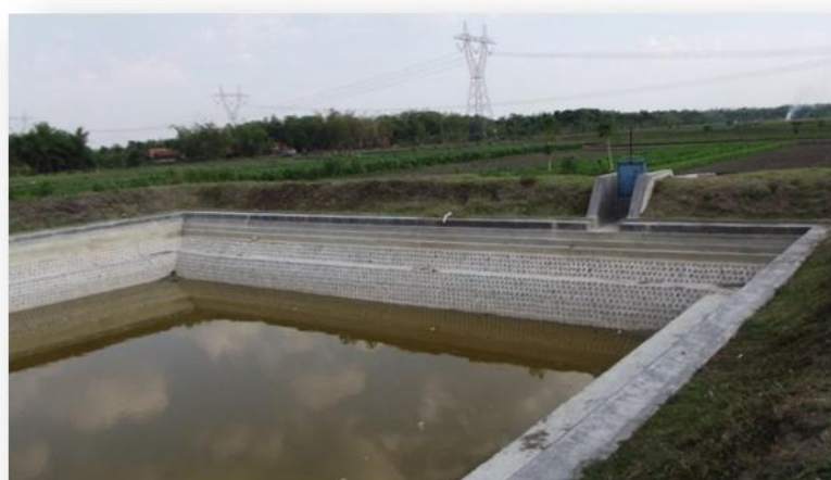
Gambar 13. Sumber air area sawah tadah hujan di Desa Panunggalan, embung ukuran 20 m x 20 m x 3 m
